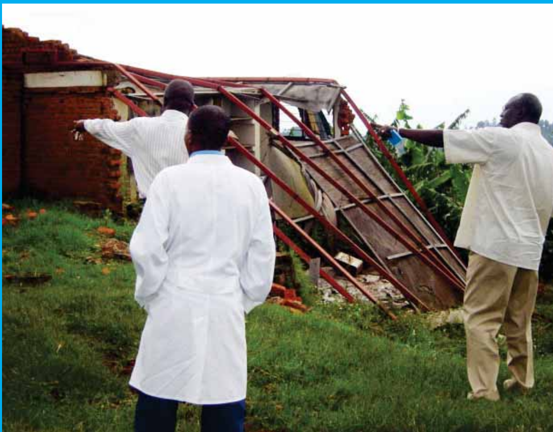
Le bâtiment de l'Hôpital de Bushenge détruit par le tremblement de terre: Visite du Représentant de l'OMS (à droite).
