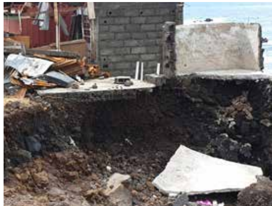
Une maison détruite au sud de l'île de Ngazidja par des grosses vagues engendrées par le passage du cyclone
