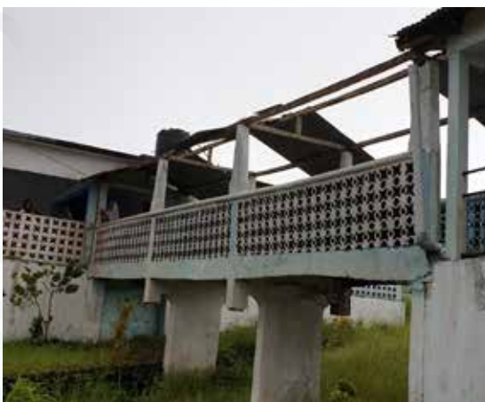
Centre de santé familiale situé dans le village de Nioumamilima, dévasté par les rafales du cyclone Kenneth
